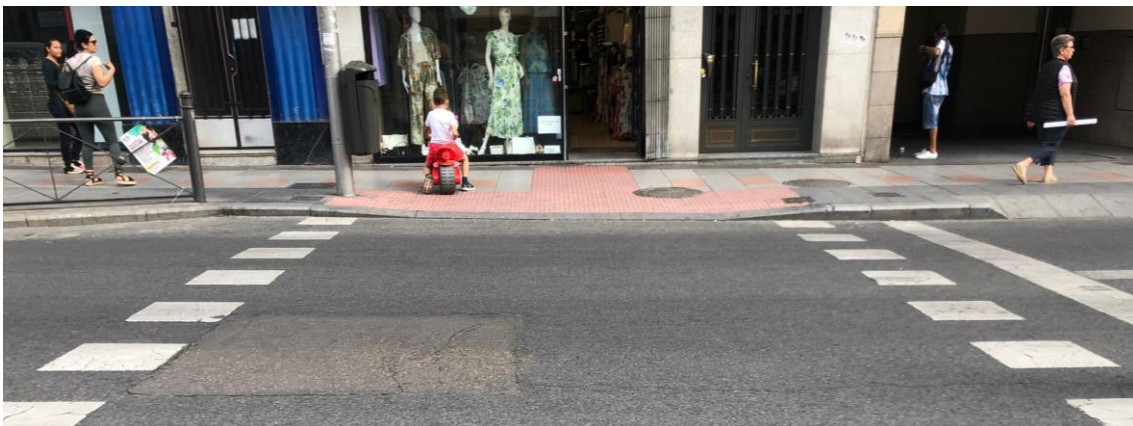
Figura 31. Paso peatonal sin pintura interior
