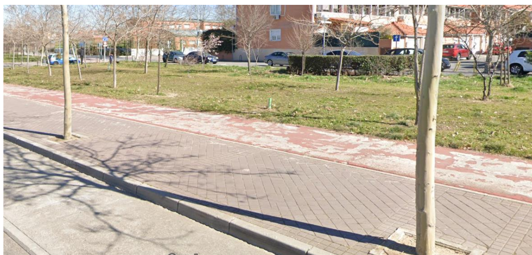
Figura 75. Carril bici en deficiente estado. Paseo de Loranca
